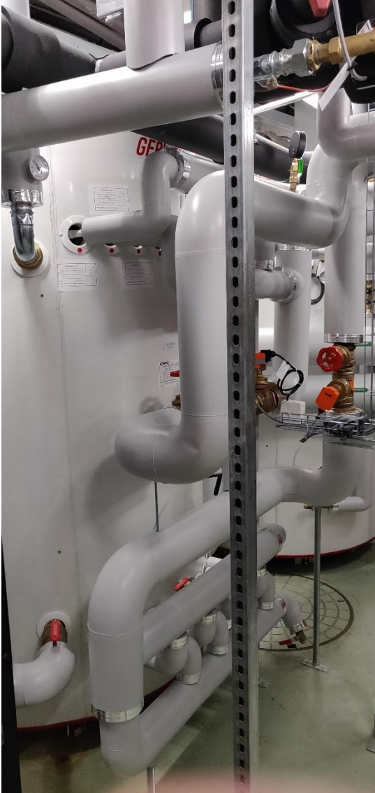
Kuva 20. Vasemmalla Musiikkitalon käyttövesivaraaja ja taustalla puskurivaraaja.
