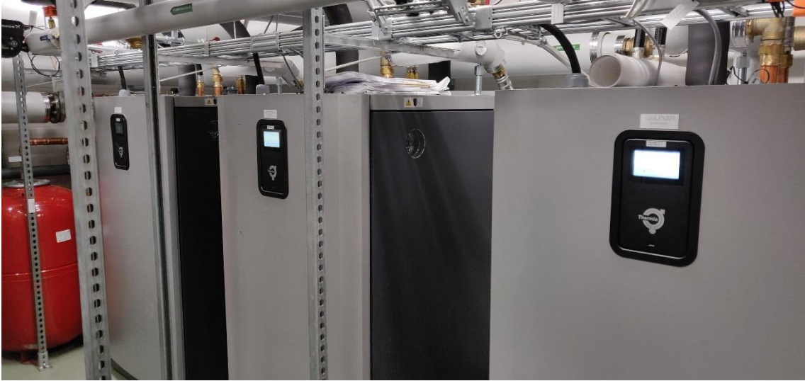
Kuva 17. Kuvassa esitettyä kaikki kolme Thermia Mega XL lämpöpumppua.
