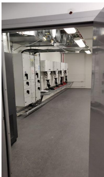
Kuva 10. Kuva Musiikkitalon ohjauskeskuksesta.
