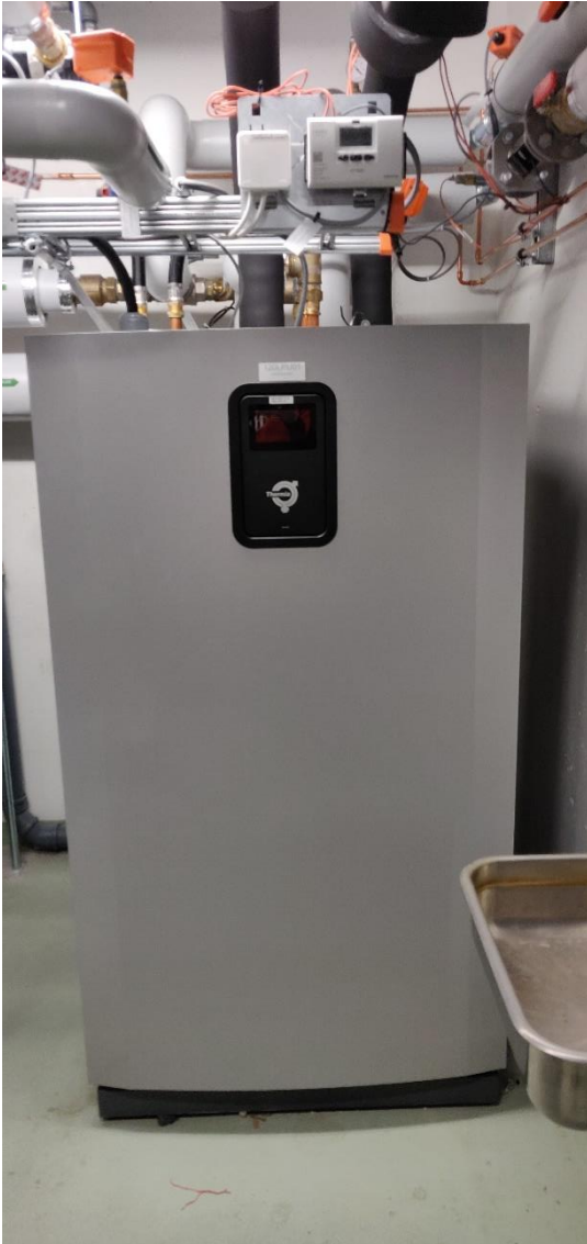
Kuva 16. Thermia Mega XL lämpöpumppu 1 asennettuna Musikiitalolla.
