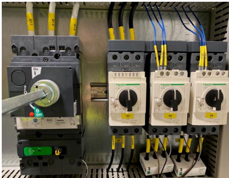
Kuva 17. Energiamittauskomponentit asennettuna sähkökeskukseen.
