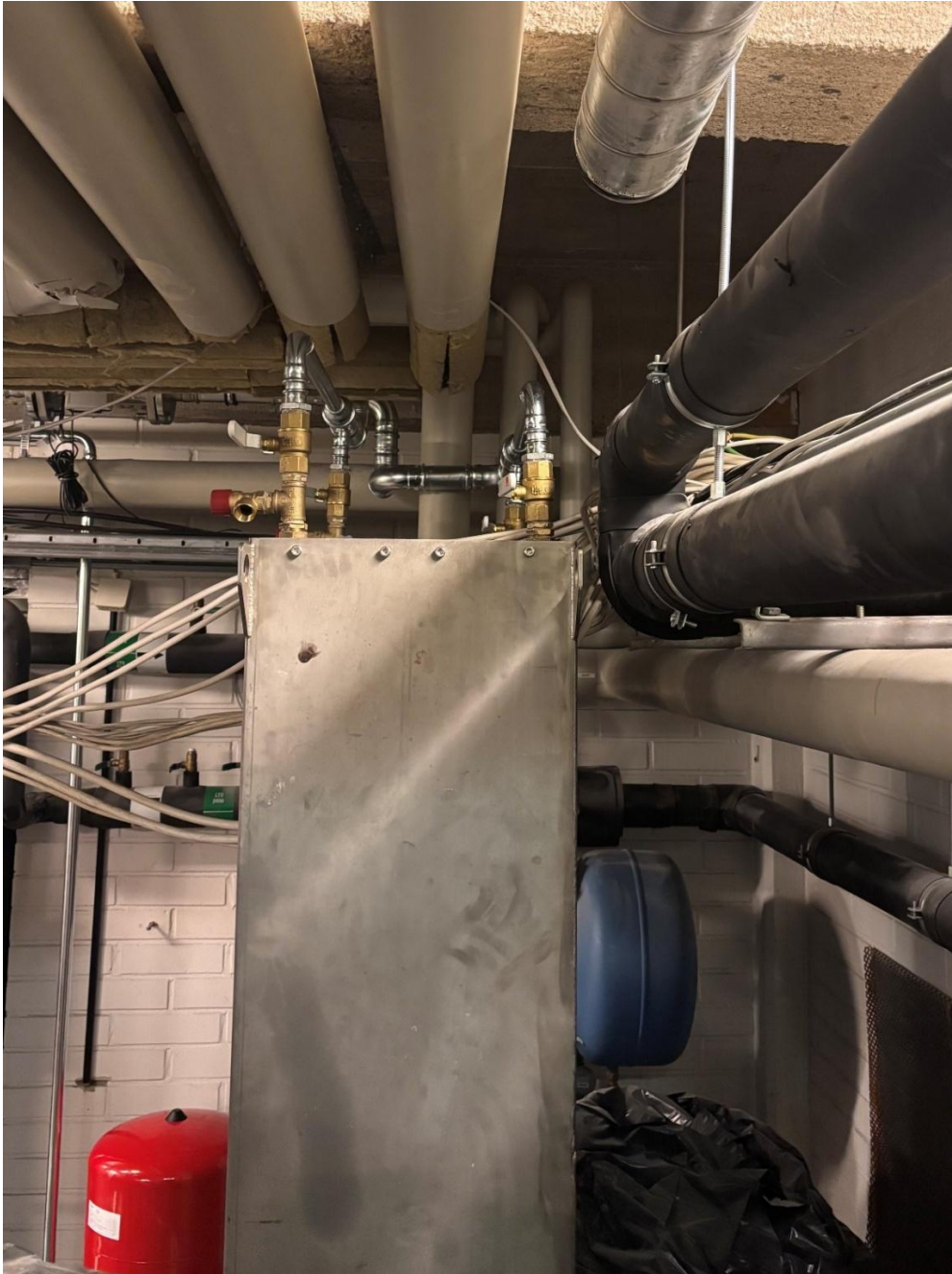
Kuva 6. Lämpöenergian varastointiyksikkö kuvattuna sivulta päin.
