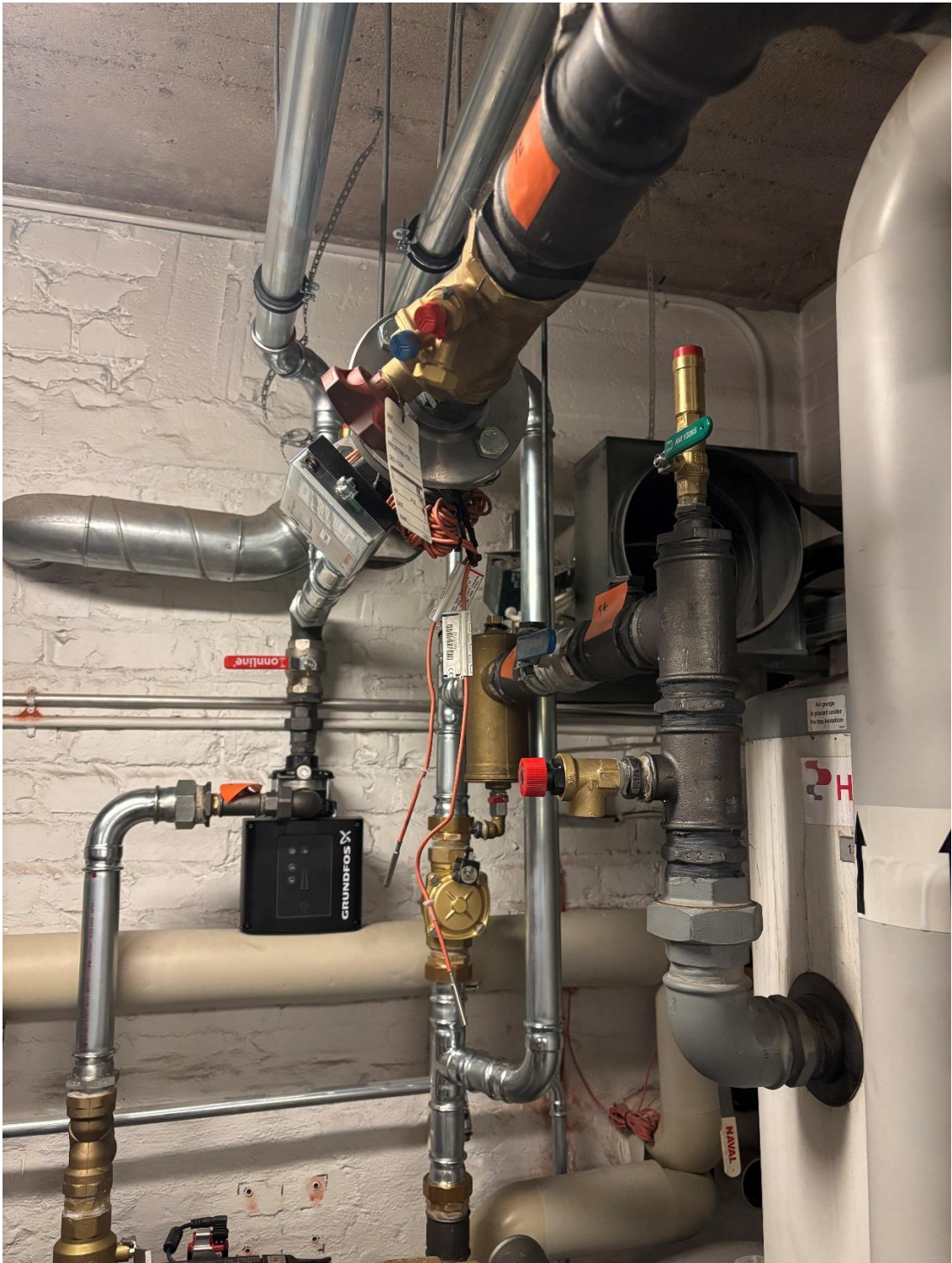
Kuva 10. Testausjärjestelmän ja rakennuksen lämmönjakoverkon välinen putkisto
