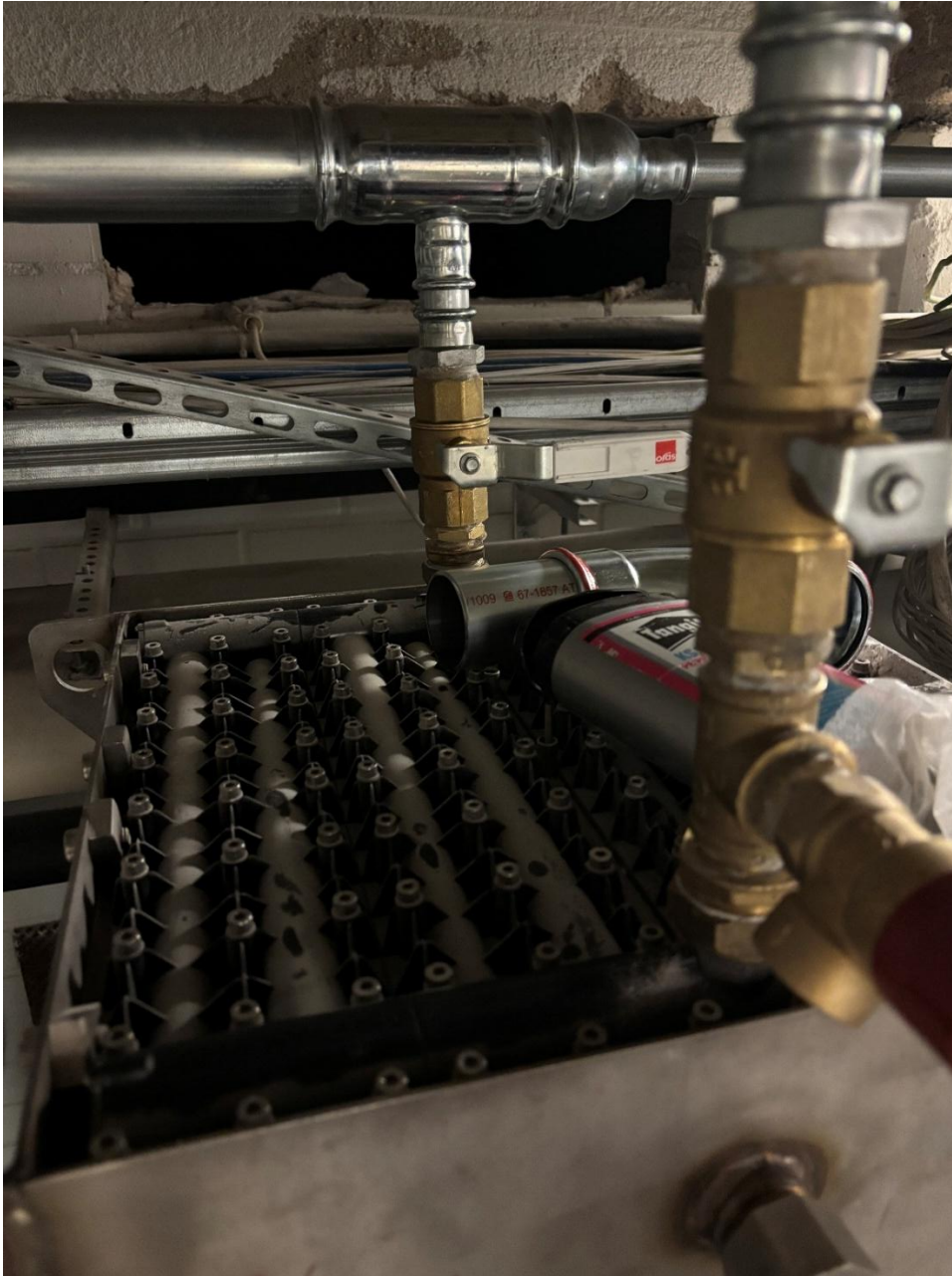
Kuva 5. Lämpöenergian varastointiyksikön ylämoduuli.
