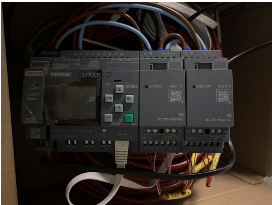
Kuva 7. Mittausjärjestelmän sähkönsyöttöyksikkö Siemens LOGO!Power sekä siihen liitetyt lisäkomponentit.
