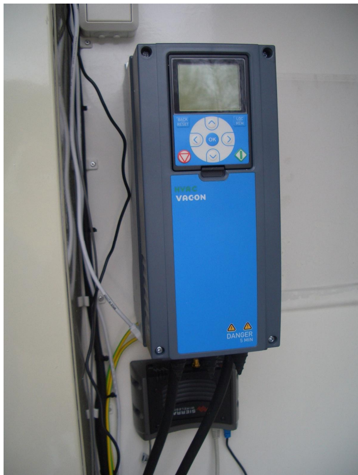
Kuva 4. Vacon 10 -taajuusmuuttaja ja sen alla langaton reititin asennettuina vaunun etuosan suojattuun tilaan.
