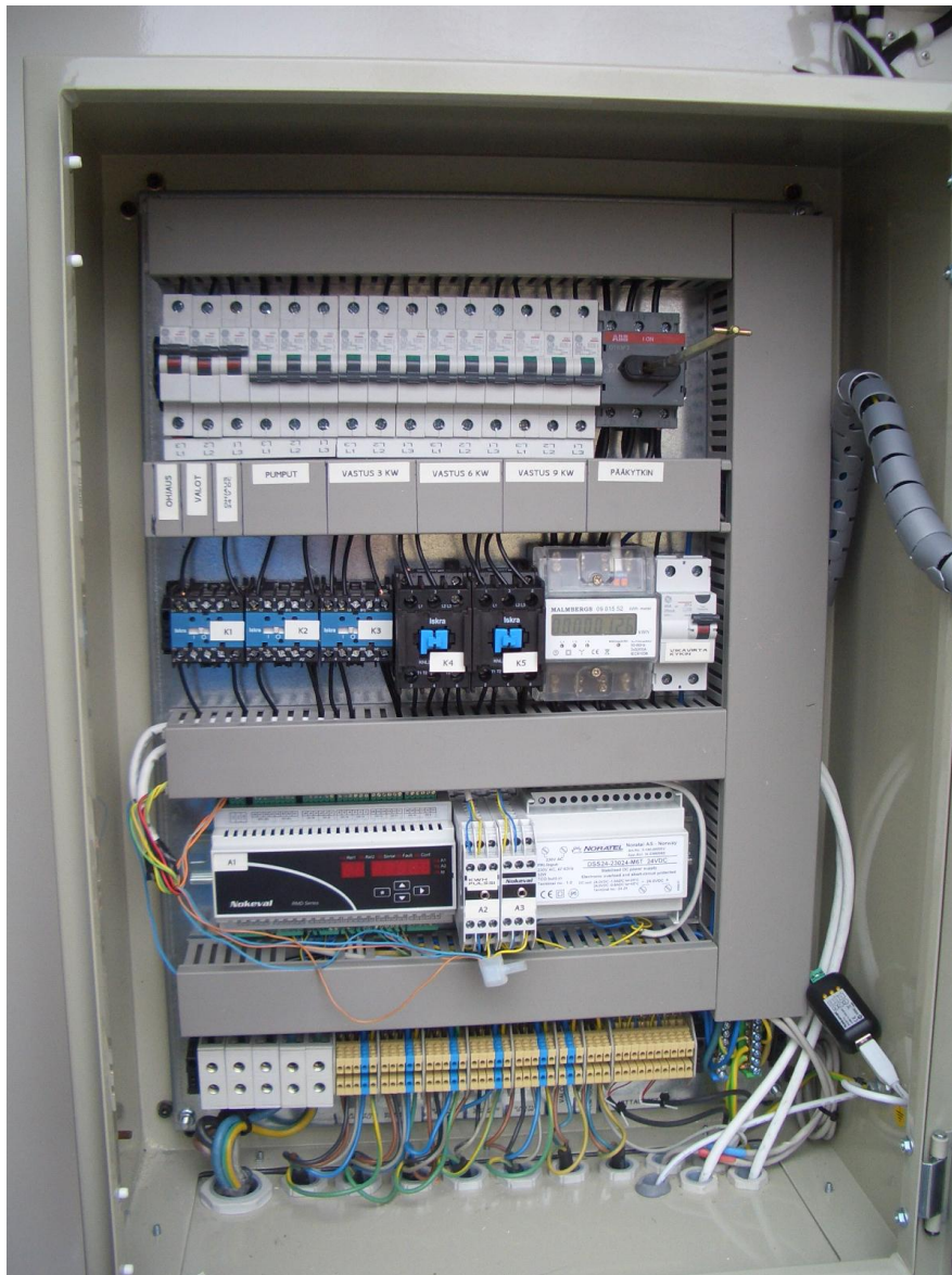
Kuva 19. Sähkökeskus asennettuna vaunun etuosaan, yläosassa on pääkytkin ja varokkeet. Seuraavassa tasossa ovat kontaktorit, energiamittari ja vikavirtasuojat. Näiden alapuolella ovat mittauslähetin, mittamuuntimet ja tasavirtalähde. Alareunassa ovat riviliittimet kytkentöjä varten.
