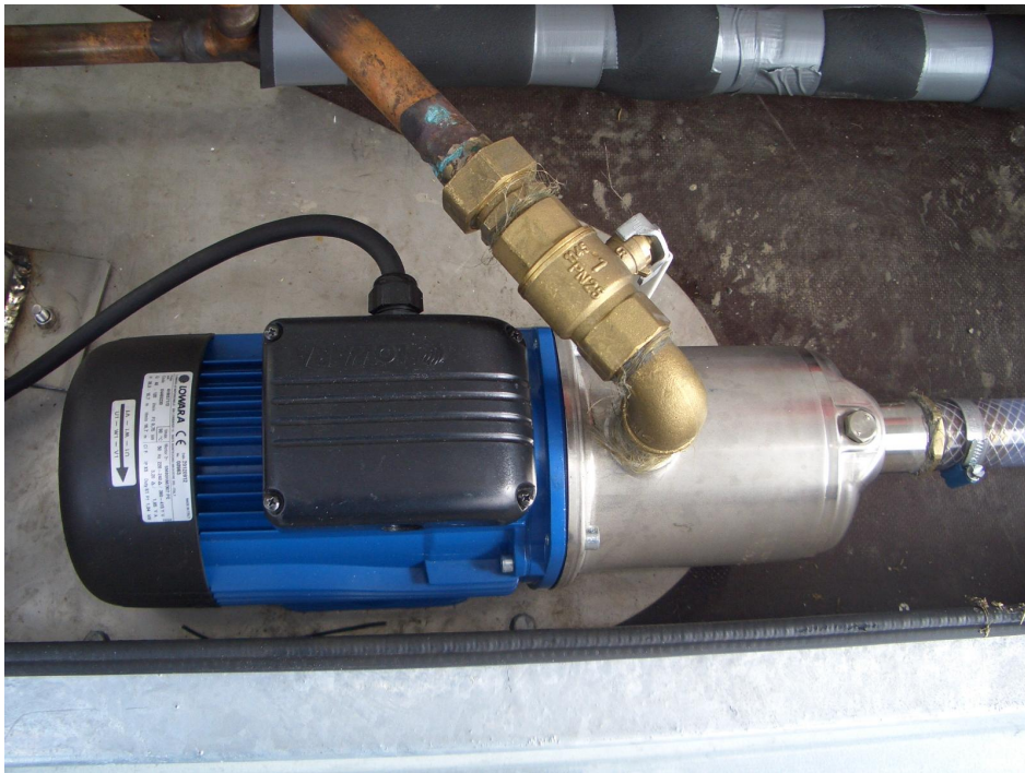
Kuva 5. Kuvassa on järjestelmän täyttämiseen tarkoitettu keskipakoispumppu pultattuna mittausvaunun lattiaan kiinnitettyyn asennuslevyyn.
