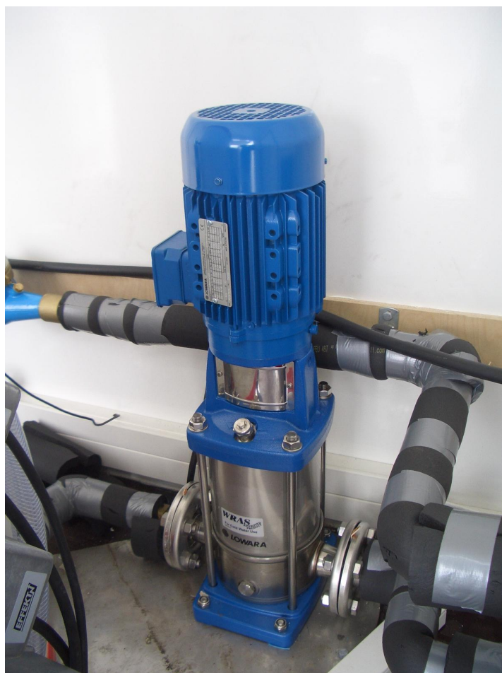
Kuva 3. Mittausvaunuun asennettu kiertovesipumppu Lowara 10SV05, joka on kiinnitetty asennuslevyyn haponkestävin teräspulteihin.
