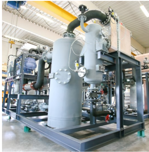
Kuva 24. INTEC GMK Low temperature ORC Power Plant (INTEC-energy.de).
