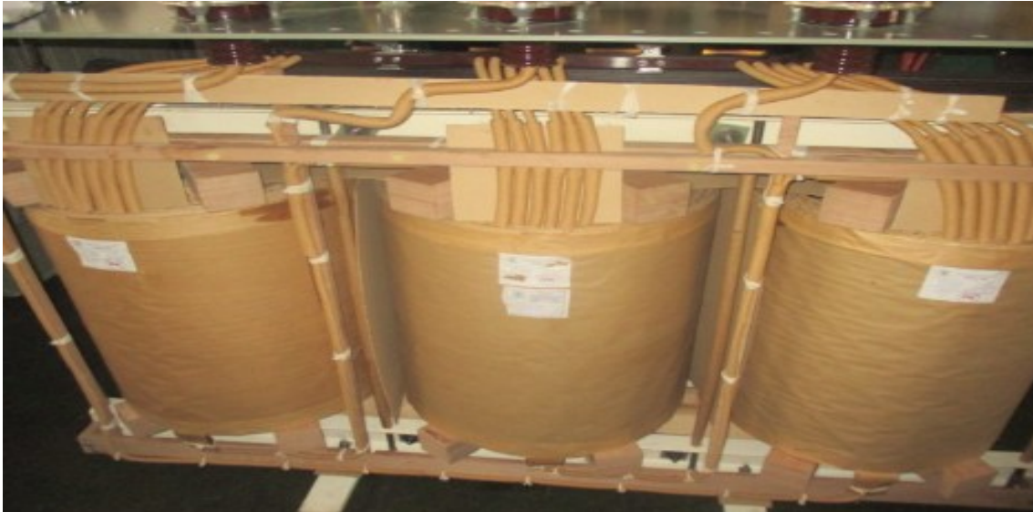
Kuva 3. Muuntajan käämit ja sisäinen johdotus (Dawood ja muut, 2019, s. 214).
