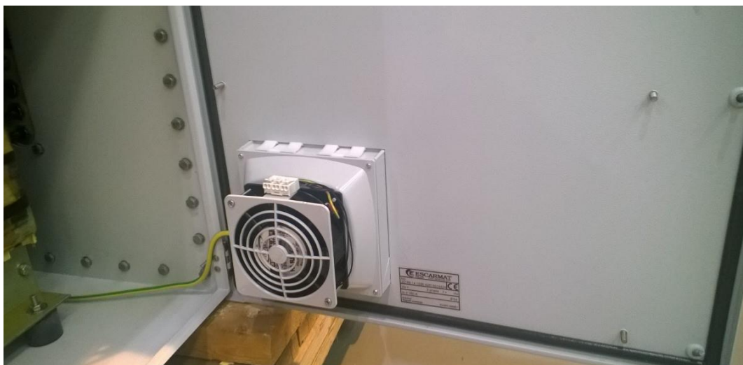
Kuva 21. Kotelon oveen asennettu tuuletin.
