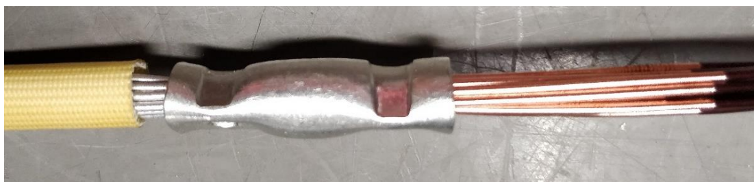
Kuva 15. Käämivyyhdin jatkoliitos, jossa vasemmalla puolella on alumiinijohdinta ja oikealla puolella kuparijohdinta. Jatkoliittimenä Ounevan JHR 16 -jatkoliitin.
