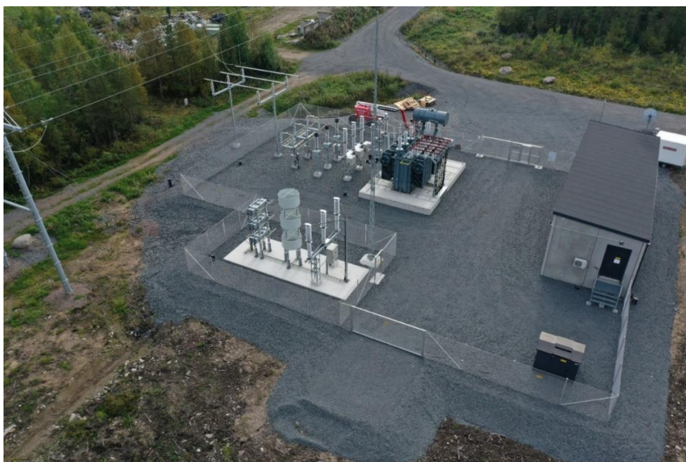
Kuva 9 Eräs kohdeyrityksen rakentama 110 kV sähköasema (Kohdeyritys, 2024)
