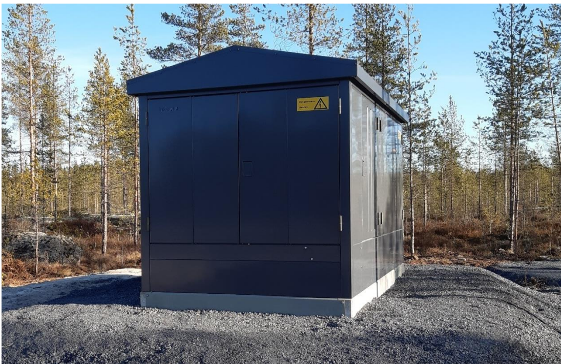
Kuva 14. Puistomuuntamo (Sari Katila, henkilökohtainen keskustelu, 12.4.2022)
