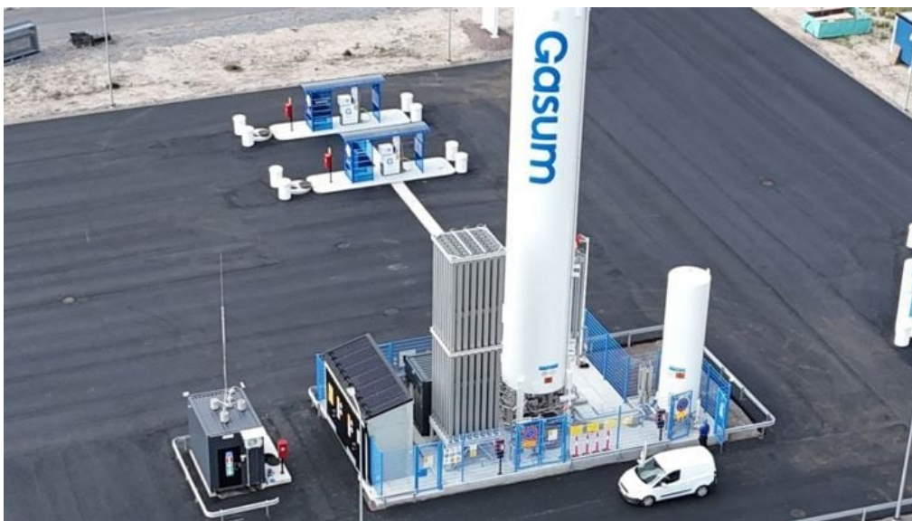
Kuva 7. Gasumin biokaasun tankkausasema Raumalla (Gasum, 2025).
