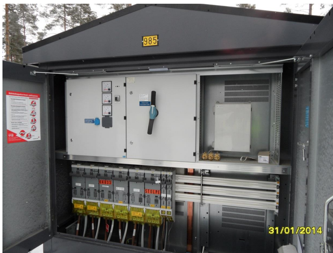
Kuva 12. Puistomuuntamo Sundomissa. PJ-puolen kojeisto näkyvissä.
