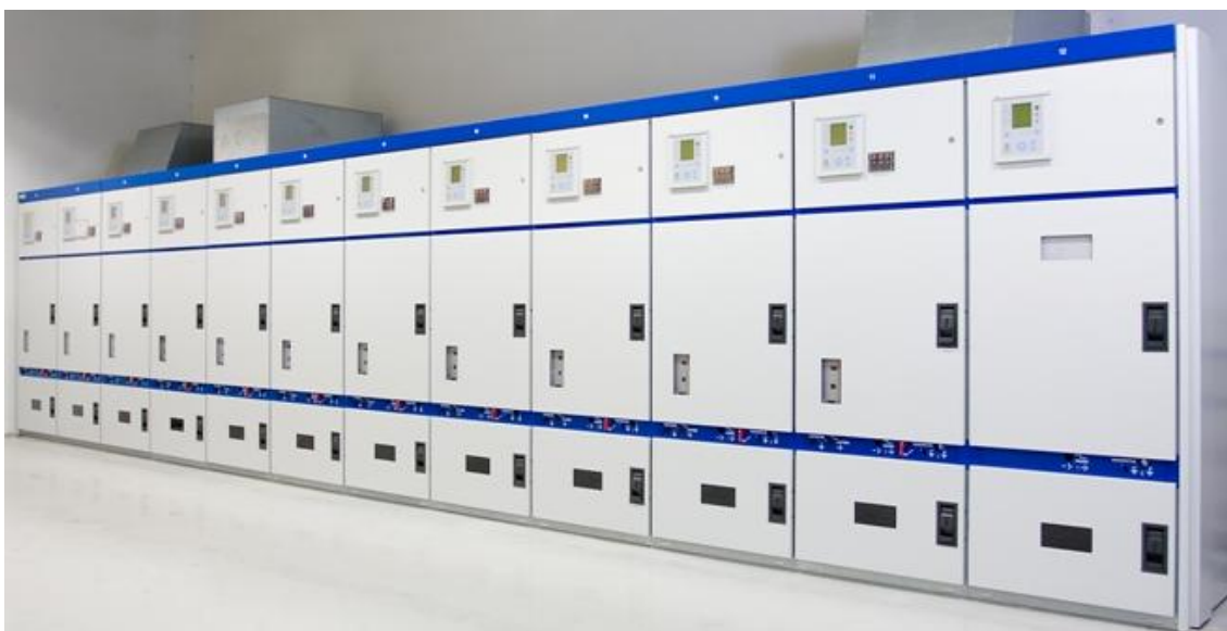
Kuva 1. Teollisuuden sähköjakelukojeisto, jossa on 12 kennoa rivissä (VEO 2010d).
