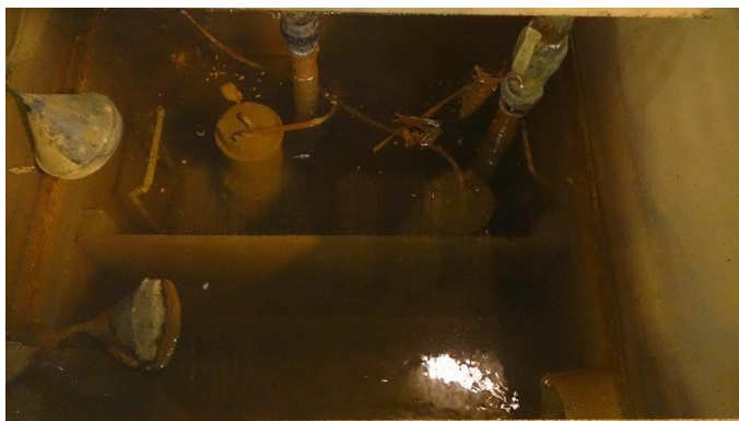
Kuva 20. Pohja- ja valumavesikaivo.
