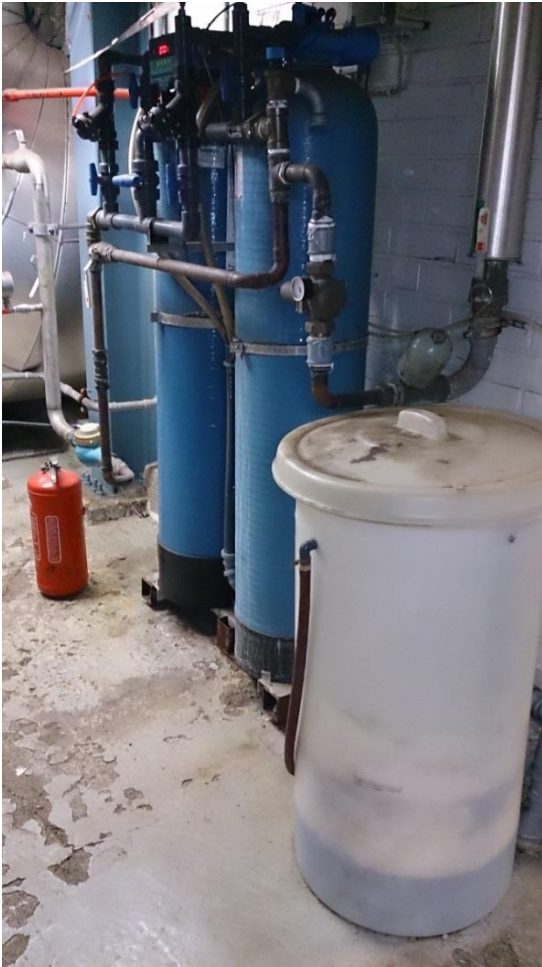
Kuva 7. Suosiolan KL-lisäveden pehmeninlaitteistoa.
