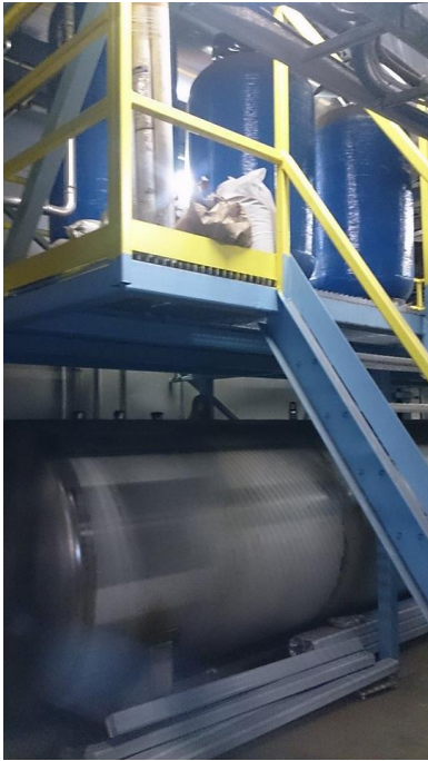
Kuva 26. Raudan- ja mangaaninsuodatuslaitteisto.
