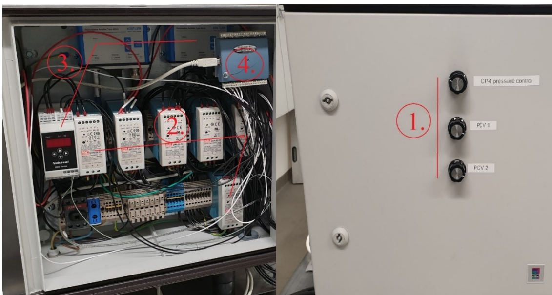
Kuva 20. Kytkentäkaappi: 1 Ohjausvirtojen säätö. 2 Teholähteet. 3 Signaalivahvistimet. 4 Tiedonkeruunmoduuli.
