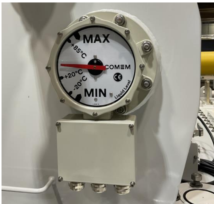
Kuva 17. Paisuntasäiliöön kiinnitetty muuntajan öljynkorkeuden osoitin.
