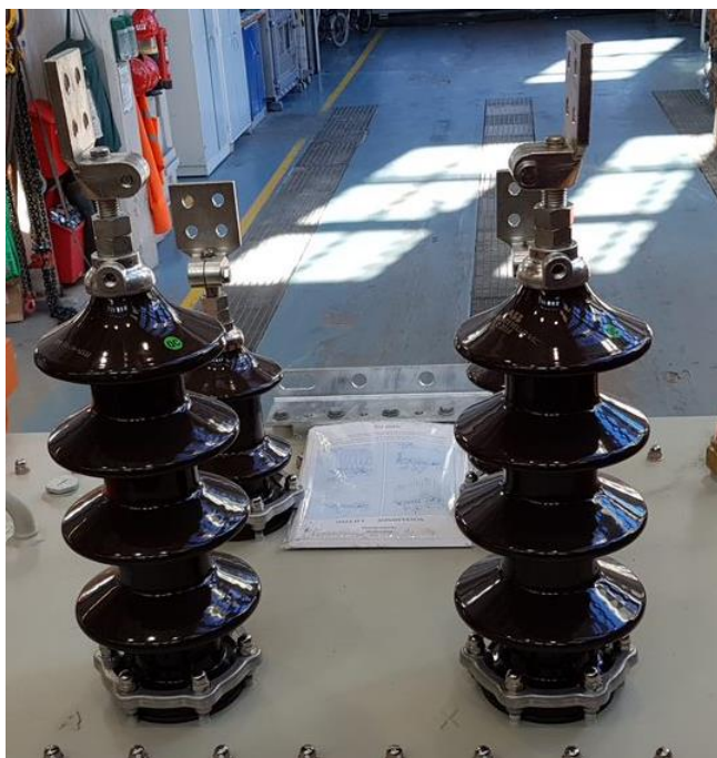
Kuva 15. Posliiniläpivientejä muuntajan kannella.
