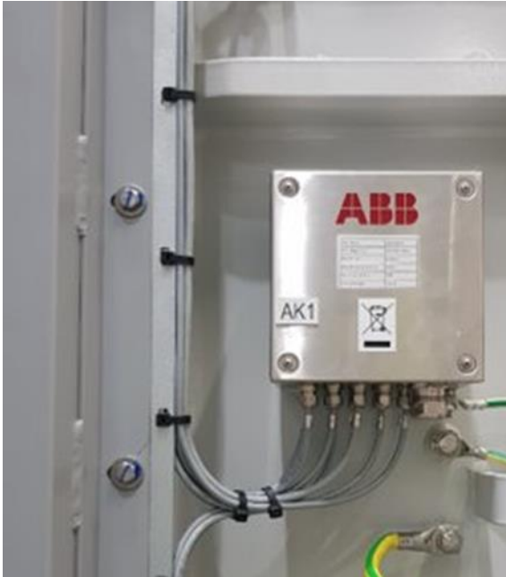
Kuva 18. Muuntajan apujohtokaappi ja sille tuleva ulkoinen johdotus.
