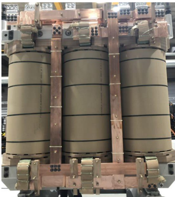
Kuva 9. Kuparinen alajännitekiskosto muuntajassa.
