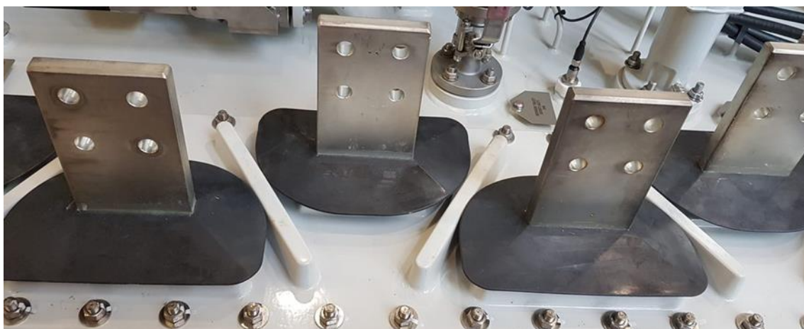
Kuva 16. Eristyslevyn läpi tulevia alajännitepuolen tinattuja kiskoläpivientejä.
