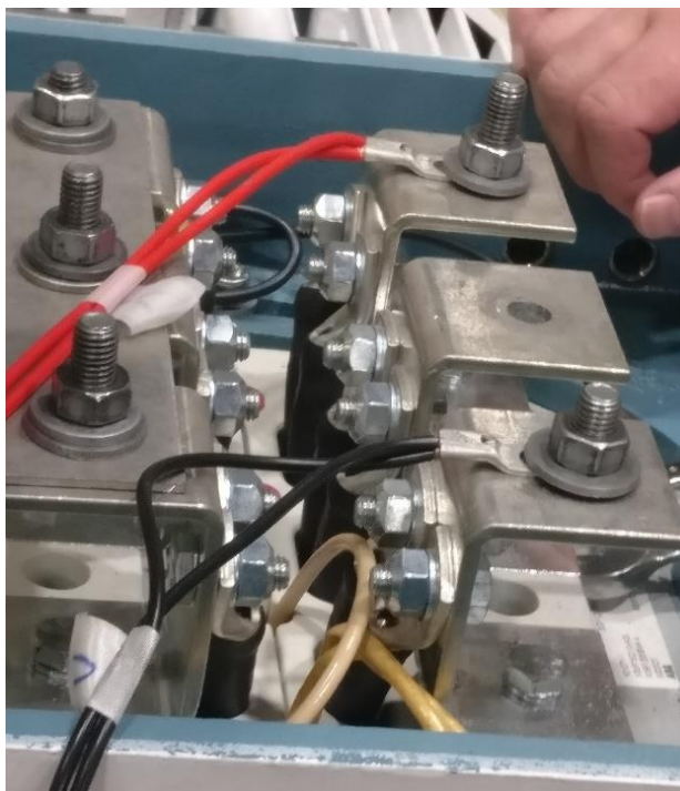
Kuva 24. Vaihevälän resistanssin mittaus U-V välistä mutterilla kiristetyillä kaapelikengillä.
