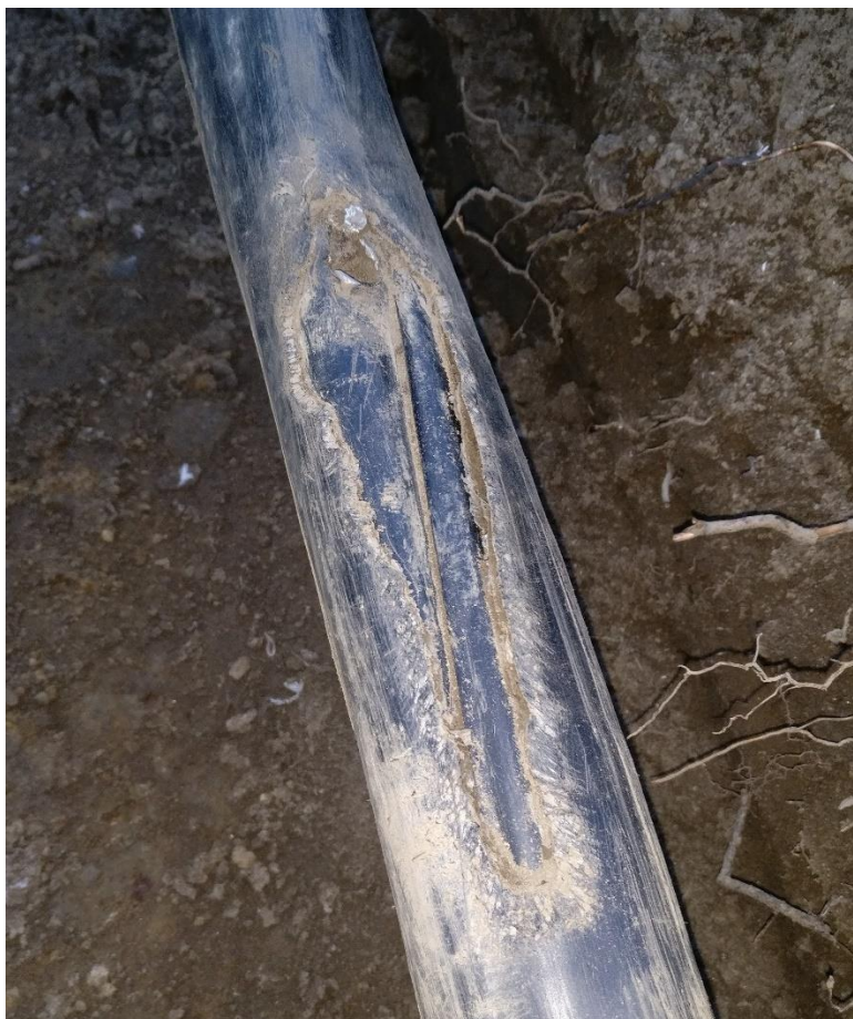
Kuva 6. Apteekin lähdöllä maasulun aiheuttanut vaurioitunut APYAKMM 3x70 mm 2 -maakaapeli.
