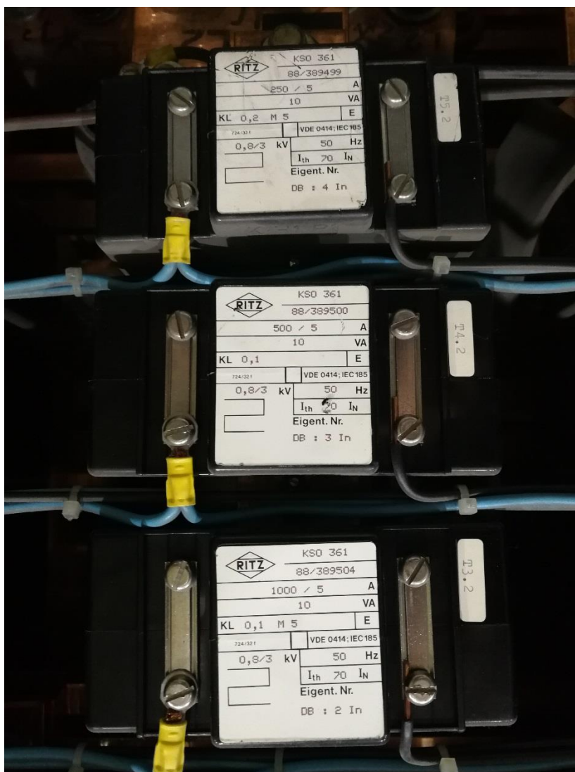
Kuva 22. TP0-testausasemalla käytössä olleet Ritzin valmistamat mittamuuntajat 250, 500 ja 1000 A:n suuruisten virtojen mittaamista varten.
