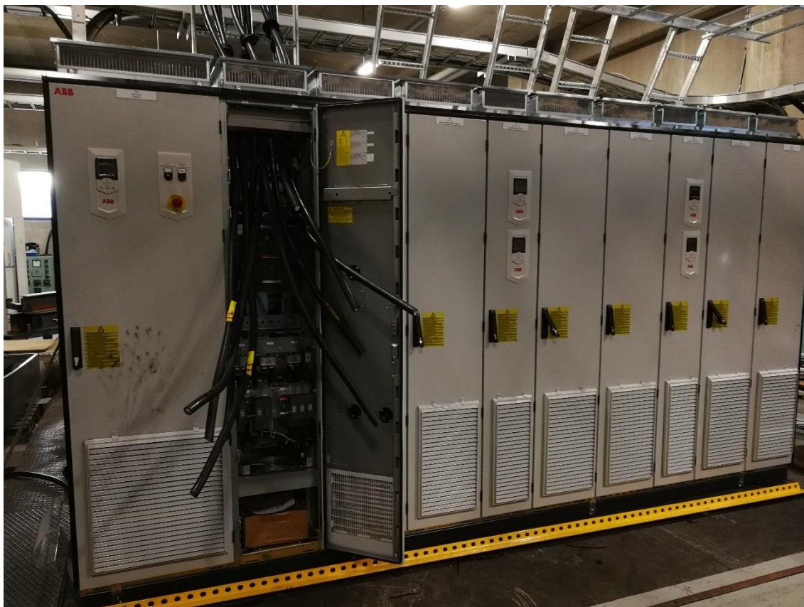
Kuva 17. TP0-testausaseman ACS880-mallin tasa- ja vaihtosuuntausyksiköt asennusvaiheessa.
