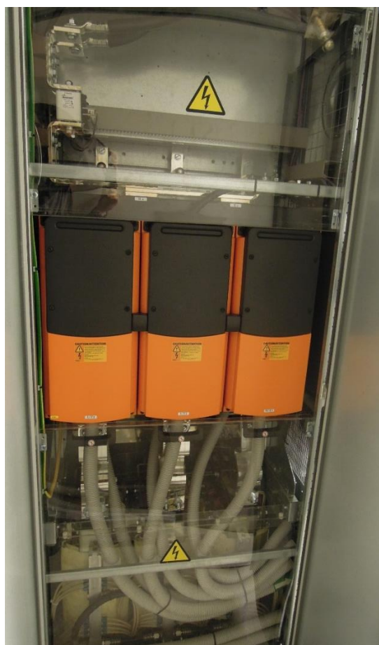
Kuva 4. Vaasan tehtaalla käytettävän verkkovaihtosuuntaajan verkon puolen invertteri. Oranssit kotelot ovat suuntaajia ja niiden alapuolella näkyvät suodatuskuristimet. Verkkovaihtosuuntaajat kuumenevat käytössä, joten ne ovat vesijäähdytteisiä. Jäähdytysveden putket näkyvät etualalla alareunassa.
