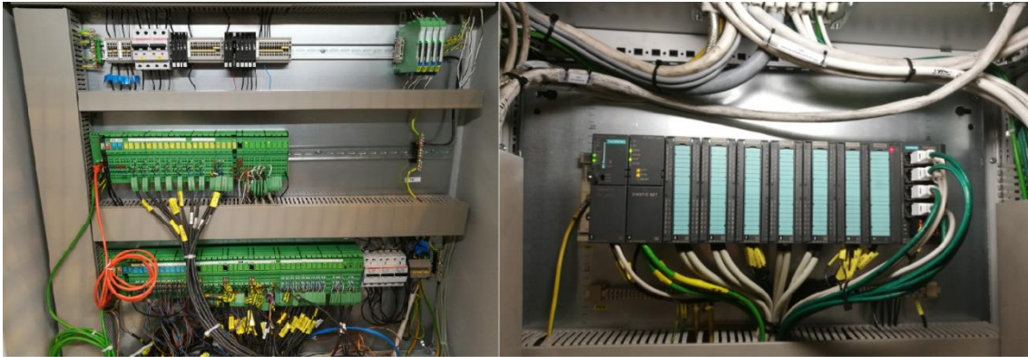
Kuva 8. Koeajon PLC-logiikoita. Vasemman puoleisen kuvan logiikat ohjaavat laitosta ja moottorin kuormitusta koeajon aikana. Oikean puoleisen kuvan logiikat ohjaavat kaasuramppia, polttoainemittauksia ja moottoriautomaatiota (Vertanen 2017).
